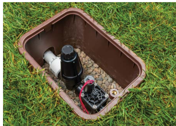
Пример установки PCZ-101 в универсальном корпусе
